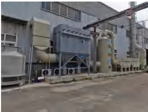
滤筒除尘+碱液喷淋+鲍尔环除湿+两级活性炭吸附系统+排气筒（编号：DA008）
