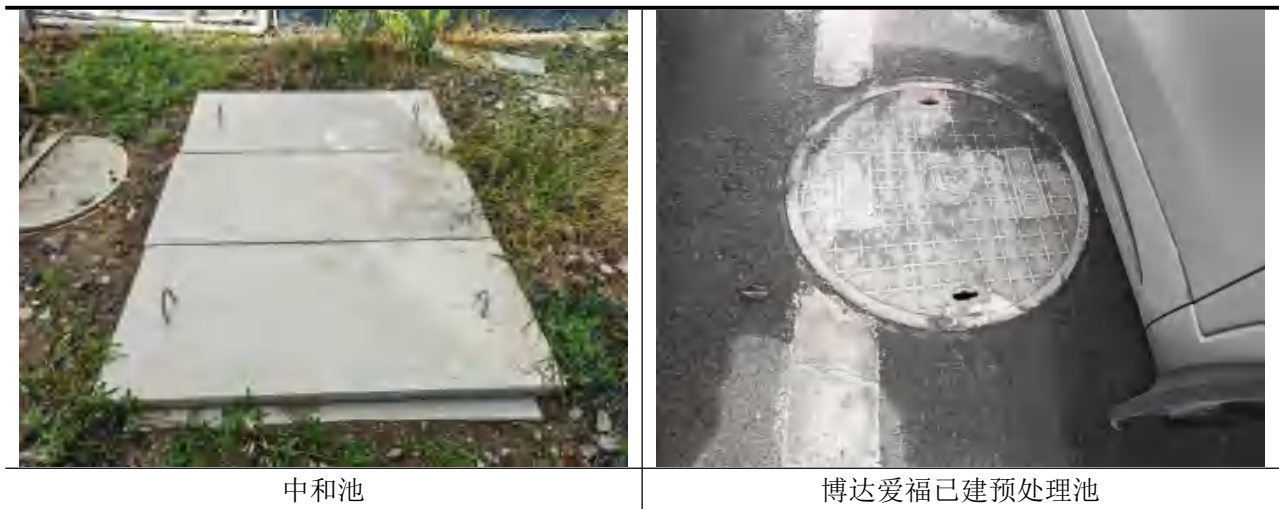
图 3-1 废水治理设施现场照片
