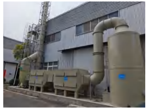
碱液喷淋+鲍尔环除湿+两级活性炭吸附系统+排气筒（编号：DA009）
