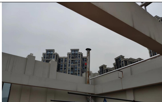
污水站废气排气筒
