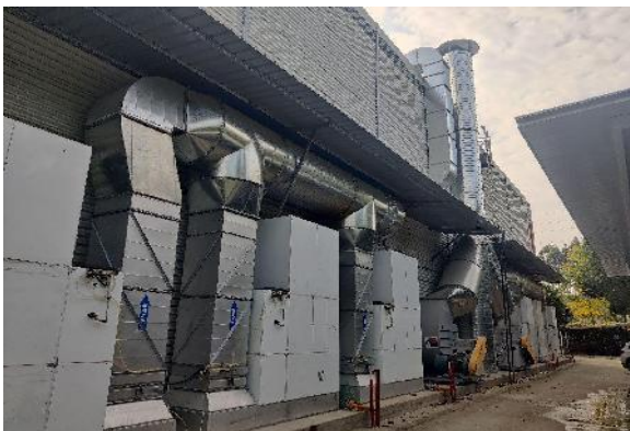
打磨粉尘(左)及有机废气排气筒(右)
