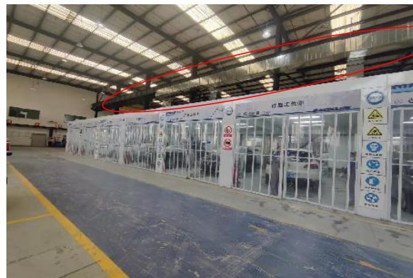
打磨区域密闭, 及其废气收集管道
