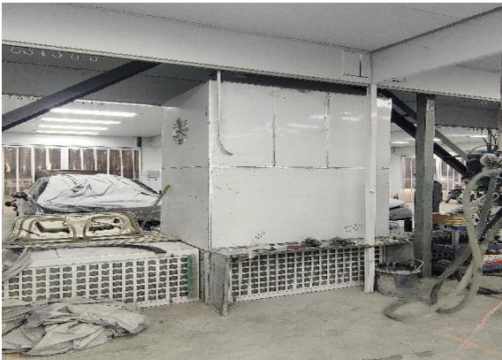
打磨区域中央集尘器
