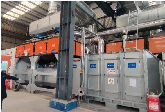
有机废气处理系统
