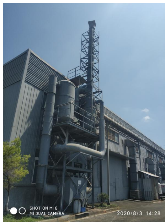
车间废气处理设施
