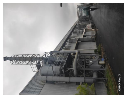
车间废气处理设施
