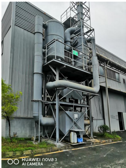
车间废气处理设施
