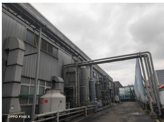
车间废气处理设施
