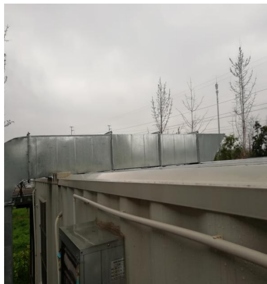
食堂油烟排气筒
