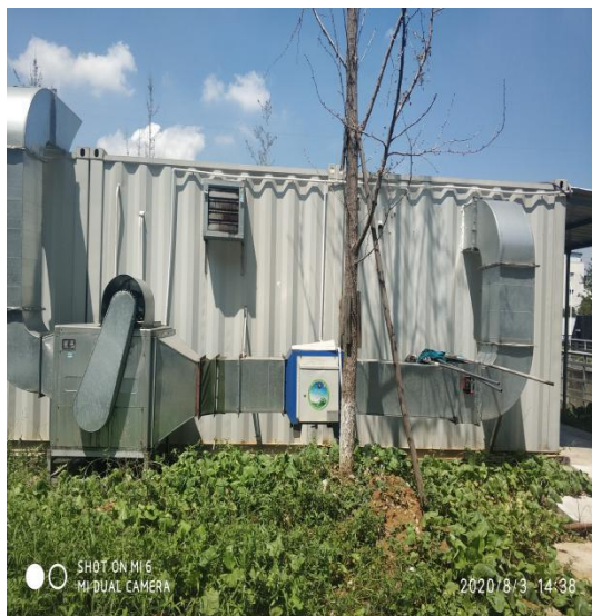
食堂油烟处理设施
